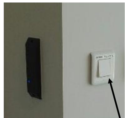
Commande d'ouverture de porte
