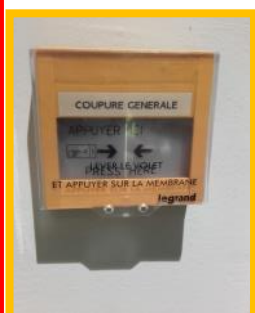
Coupe générale de toute l'électricité.
